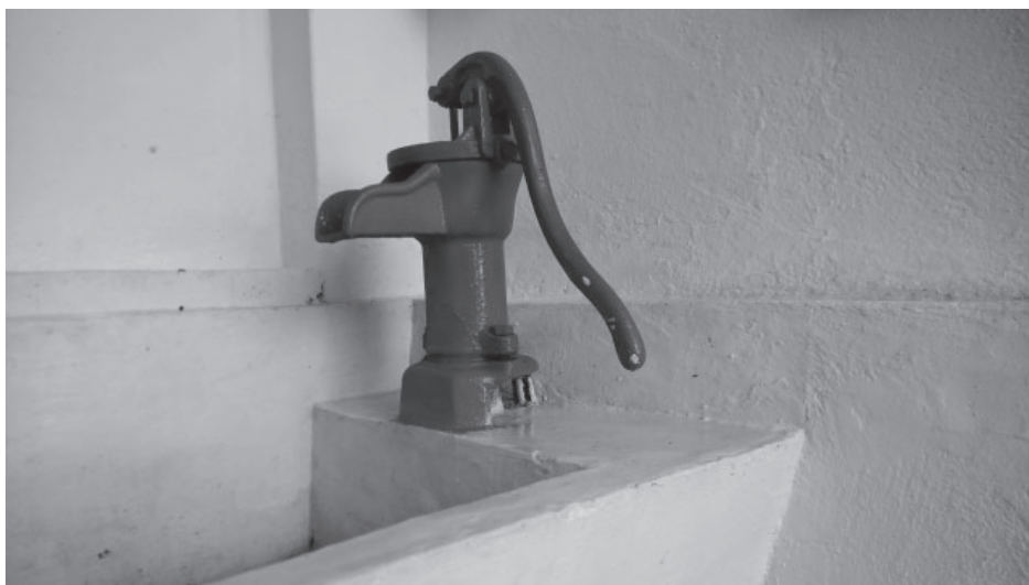
Εικ. 11. Τουλούμπα, μεταλλική κατασκευή για χειροκίνητη άντληση νερού, όπως είναι σήμερα οικία Γιαννουδάκη Κωνσταντίνου του Ιωάννη (2021).
